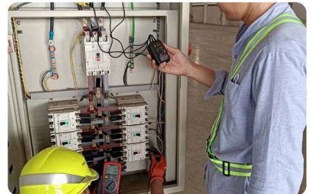
วิศวกรตรวจตู้ไฟร่วมกับช่าง
