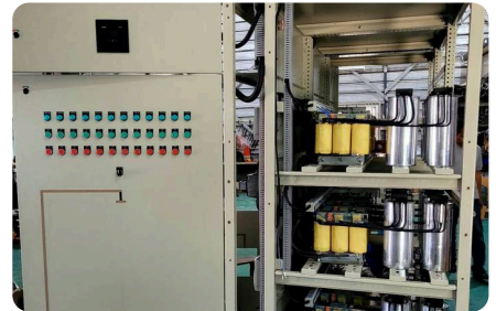
ตู้คาปาซิเตอร์แบงก์
