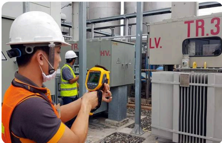
สแกนความร้อนหม้อแปลงไฟฟ้า
