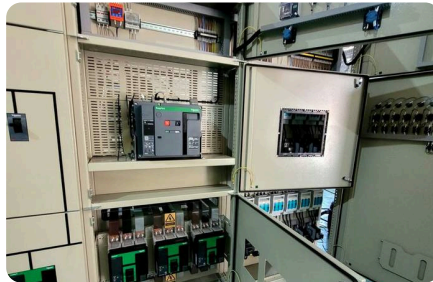
ตู้ไฟฟ้าพร้อมเบรกเกอร์และมิเตอร์
